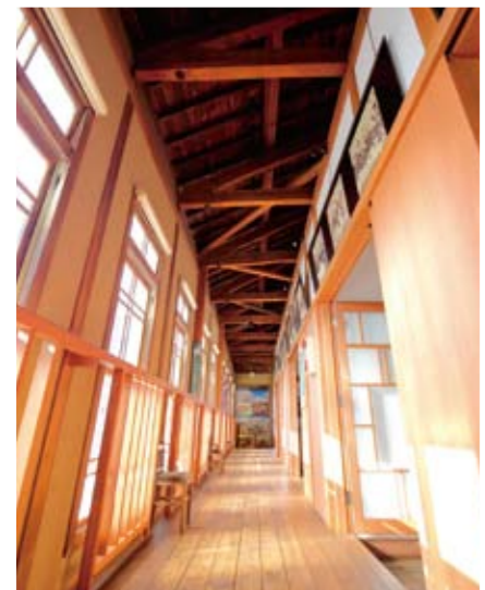
主屋の2階。天井の柱を継ぎ足している様子がわかる。現在は展示室。
