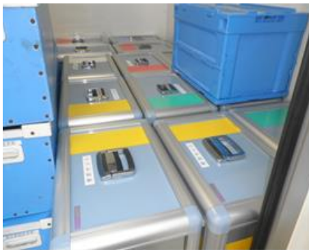
防災倉庫にある新7点セット
