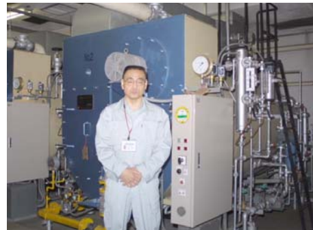
後の大きな機械がボイラーです。
