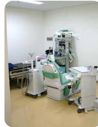
全身麻酔器を設置した個室
