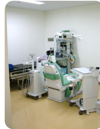
全身麻酔器を設置した個室
